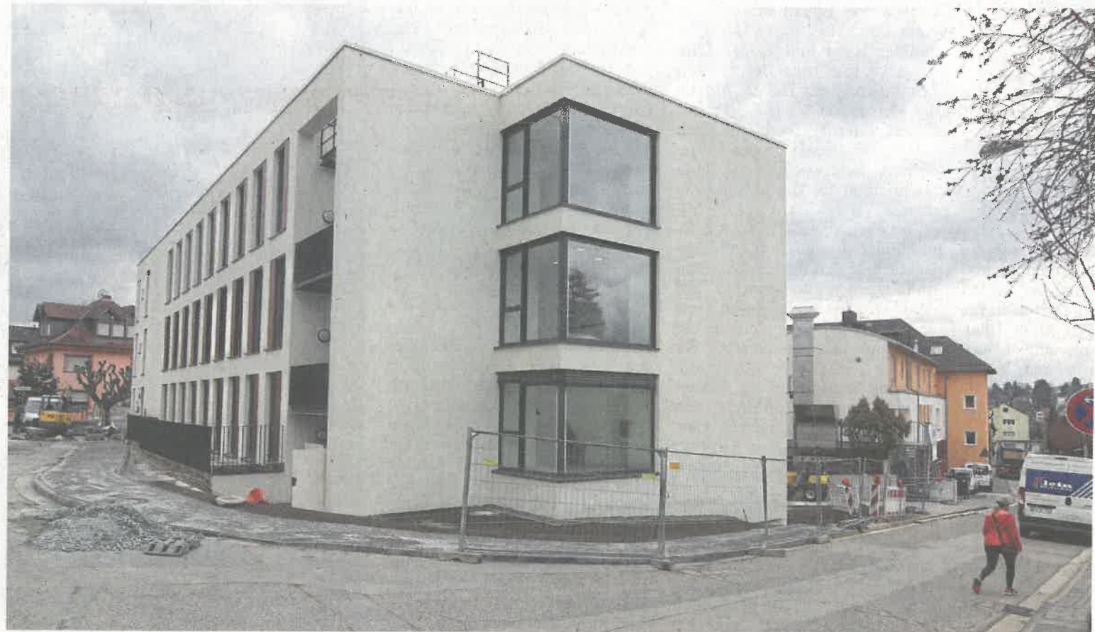
Der erste Bauabschnitt ist fast fertiggestellt, in sieben Wochen soll er bezogen werden. Es folgen dann der Abriss und der Neubau des Gebäudekomplexes an der Staufenstraße. FOTO: RED
